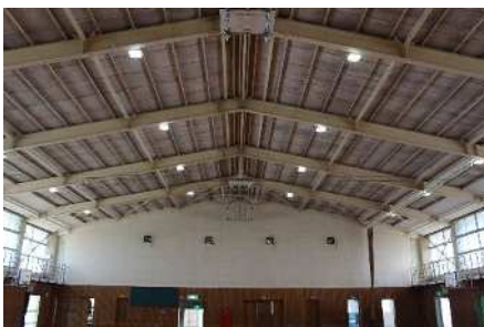
体育館LED照明
